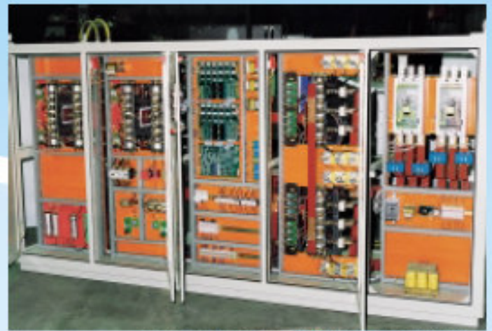
Generatore modello IMF 2000 Kw Generator model IMF 2000 Kw
