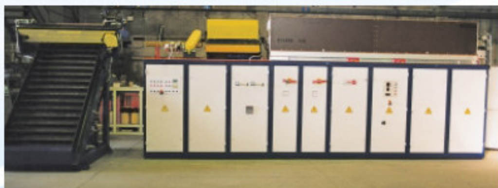
Impianto da 2000 KW per riscaldamento acciaio 2000 KW plant for steel heating
