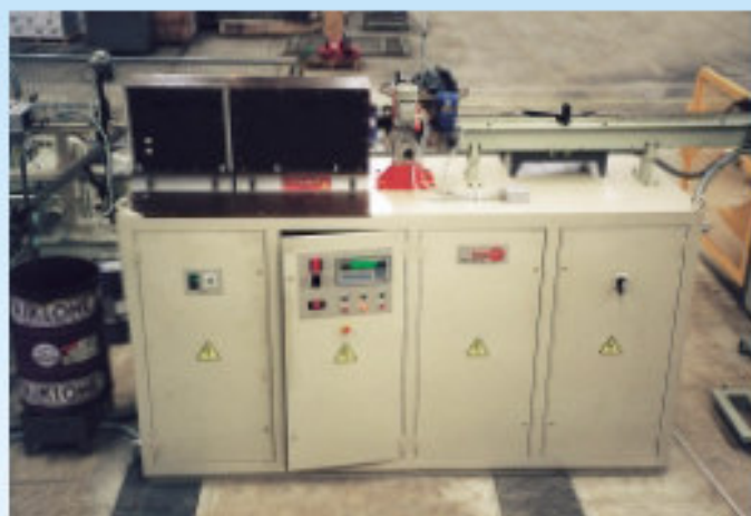
Impianto da 200 KW per riscaldamento alluminio 200 KW plant for aluminium heating
