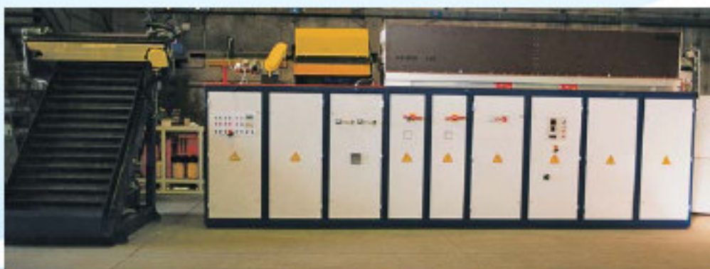
Instalación de 2000 KW para el calentamiento de acero Instalação de 2000 kW para aquecimento de aço.
