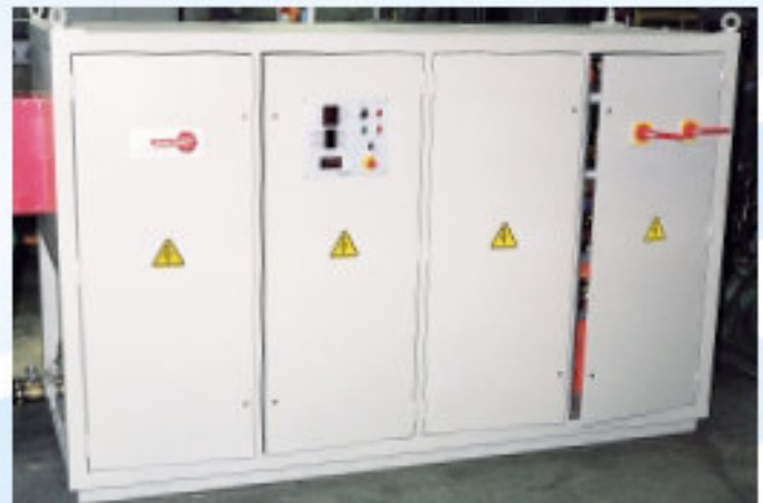
Generatore modello IMF 1000 Kw Generator model IMF 1000 Kw
