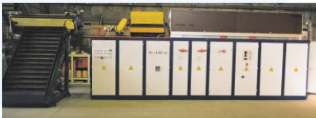
Impianto da 2000 KW per riscaldamento acciaio 2000 KW plant for steel heating
