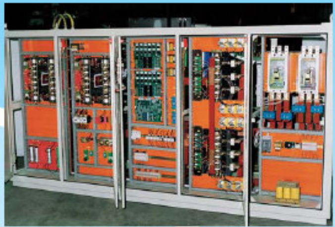
Generador mod. IMF 2000 Kw Gerador mod. IMF 2000 Kw
