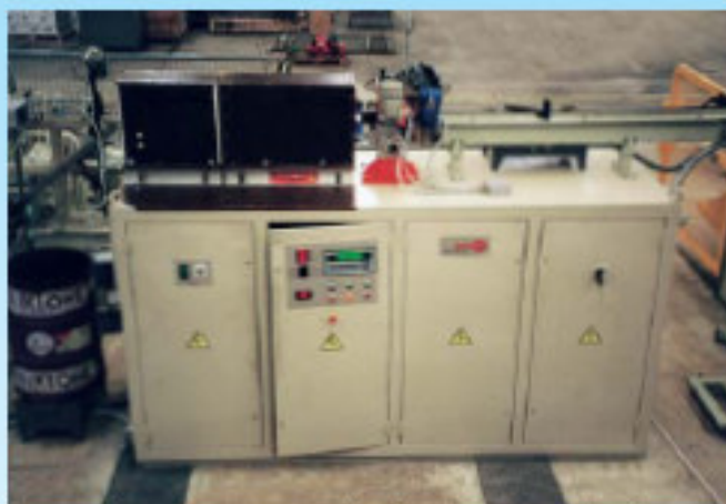
Instalación de 200 KW para el calentamiento de aluminio Instalação de 200 kW para aquecimento de alumínio.
